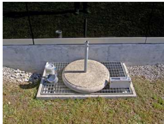
Abb. 14: Feinstaubmessungen und Luftkeimmessungen an der ebenerdigen Aussenluftfassung, Schulhaus Baden Dättwil
