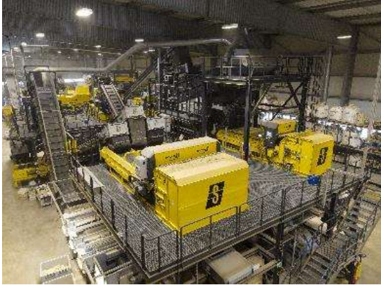
Bild 48: Technikumsanlage Firma STEINERT GmbH
